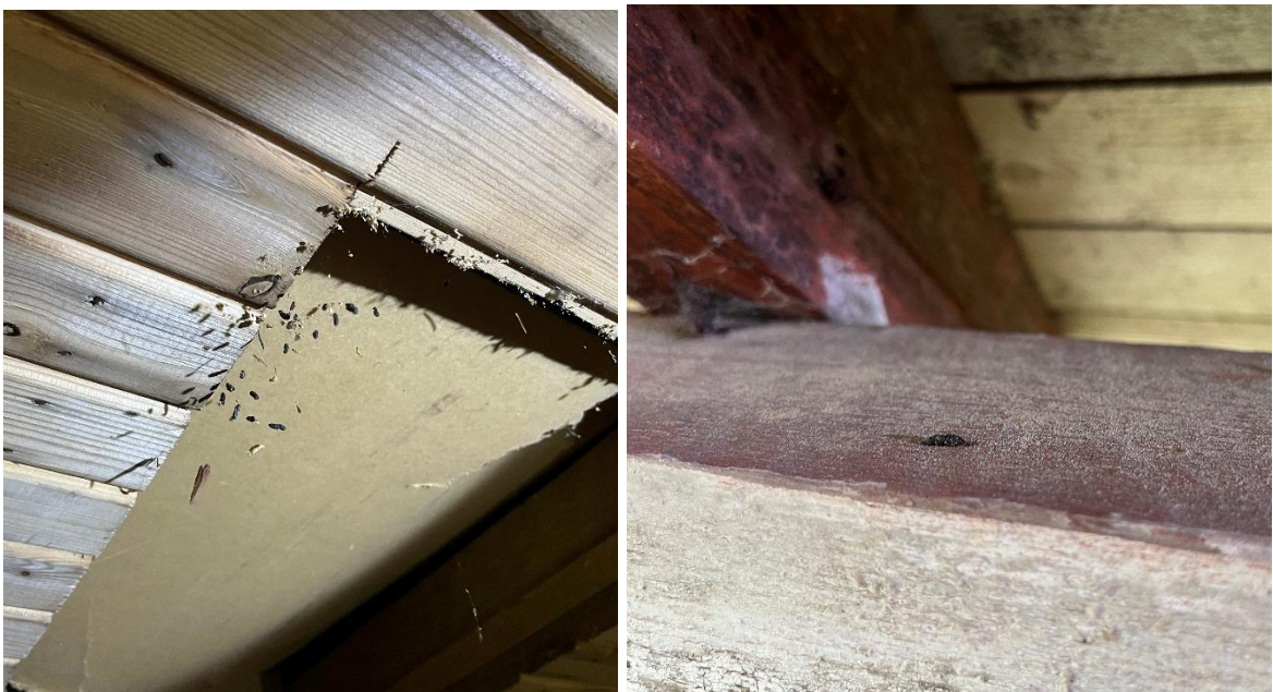
Kuva 5-5. Merkkejä lepakoista havaittiin Laukanlammen rakenteista 2025.
