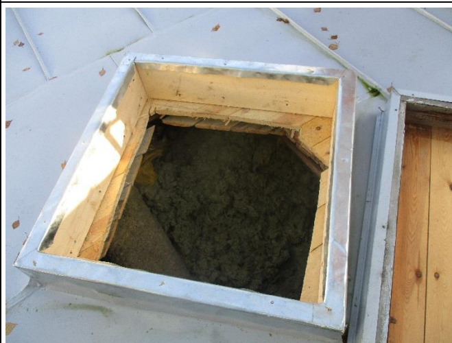
Kuva 12.6 Kulkuluukku yläpohjaan, luukun kiinnitysketjut puuttuvat
