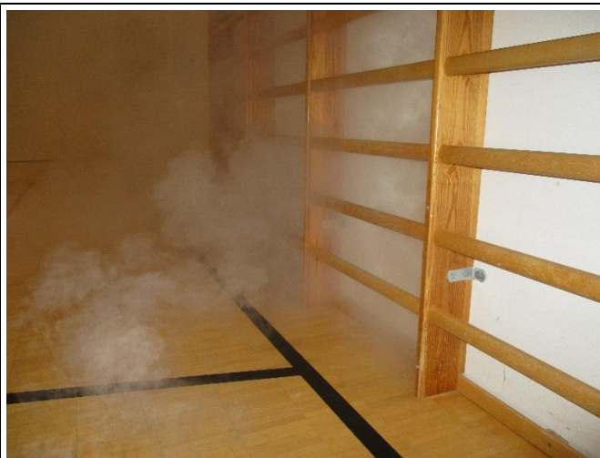
Kuva 8.3 Liikuntasalin ilmanvaihdon tarkastelu, savu ei virrannut lattiaraoista lattian alapuoliseen tilaan
