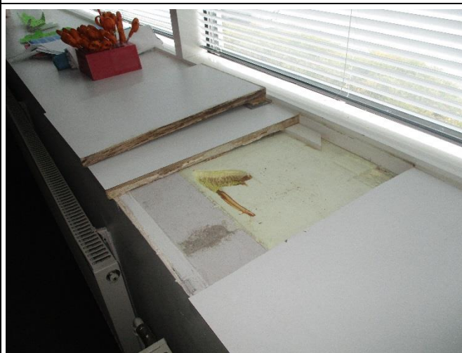
Kuva 15.10 Ikkunapenkki rakenneavaus luokka 156
