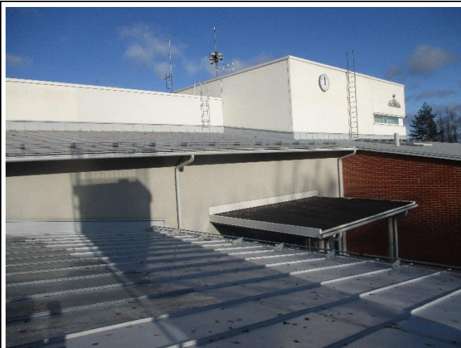
Kuva 12.2 Vesikatto on paikkakorjattu aikaisemmin
