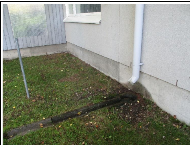
Kuva 6.2 Sadevesien ohjausta 1996 osalla
