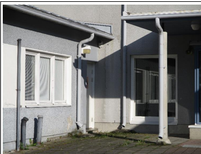
Kuva 6.1 Sadevedet johdetaan rakennuksen vierustoiille, rännistä tulleet kattovedet ovat kastelleet ruokasalin seinää
